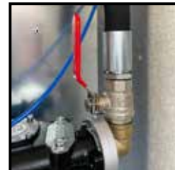
Vanne pour couper l'alimentation vers la pompe
